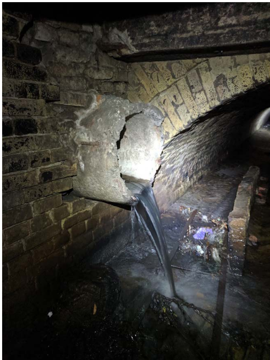
Злив води під Житнім ринком в колектор Глибочиці
